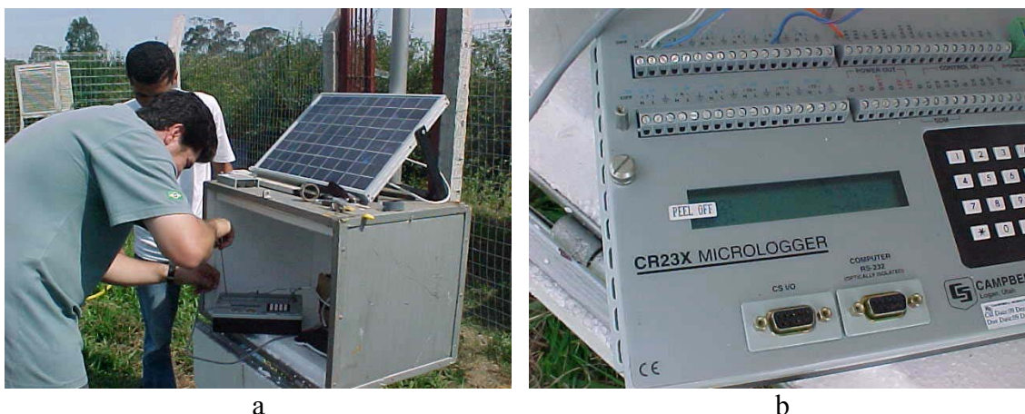
Figura 17 – Montagem da caixa central (a) e datalogger (b) para armazenamento de dados meteorológicos.
