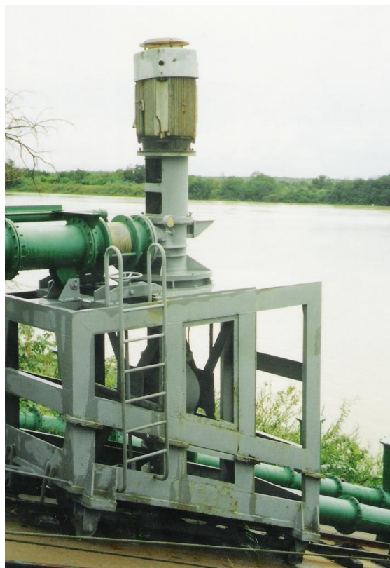
Figura 25 – Bomba de Sucção
