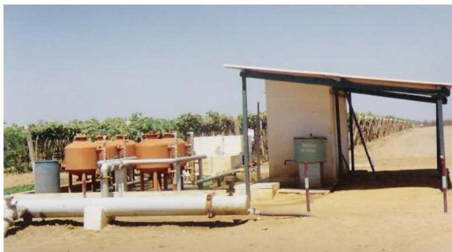
Figura 24 – Sistema de Ferti-irrigação
