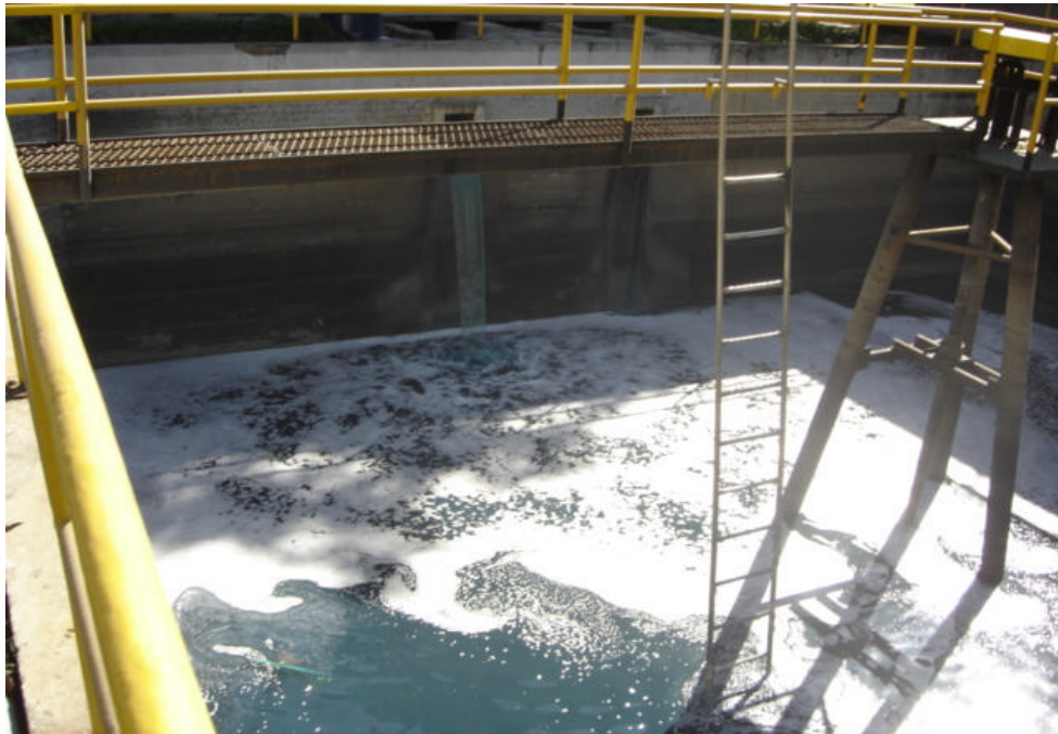
IMAGEM 03: Tanque de equalização da Indústria Têxtil Jaraguá S.A
