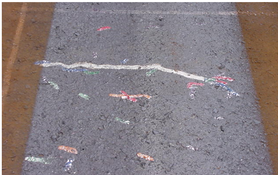
Figura 6.39: Foto do trincamento na seção 3 quando N= 462.000
