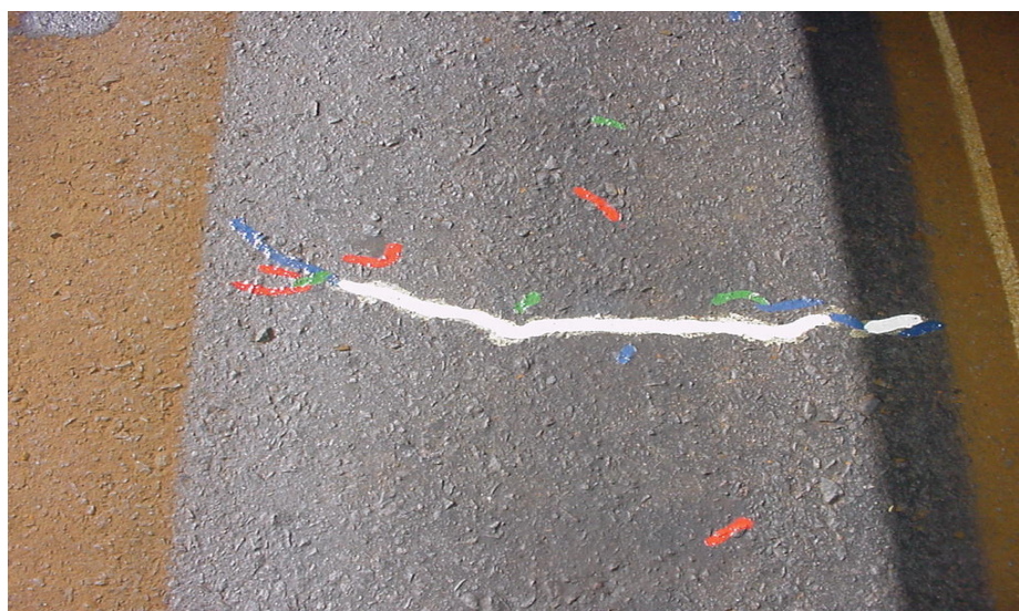
Figura 6.38: Foto do trincamento na seção 3 quando N= 205.000
