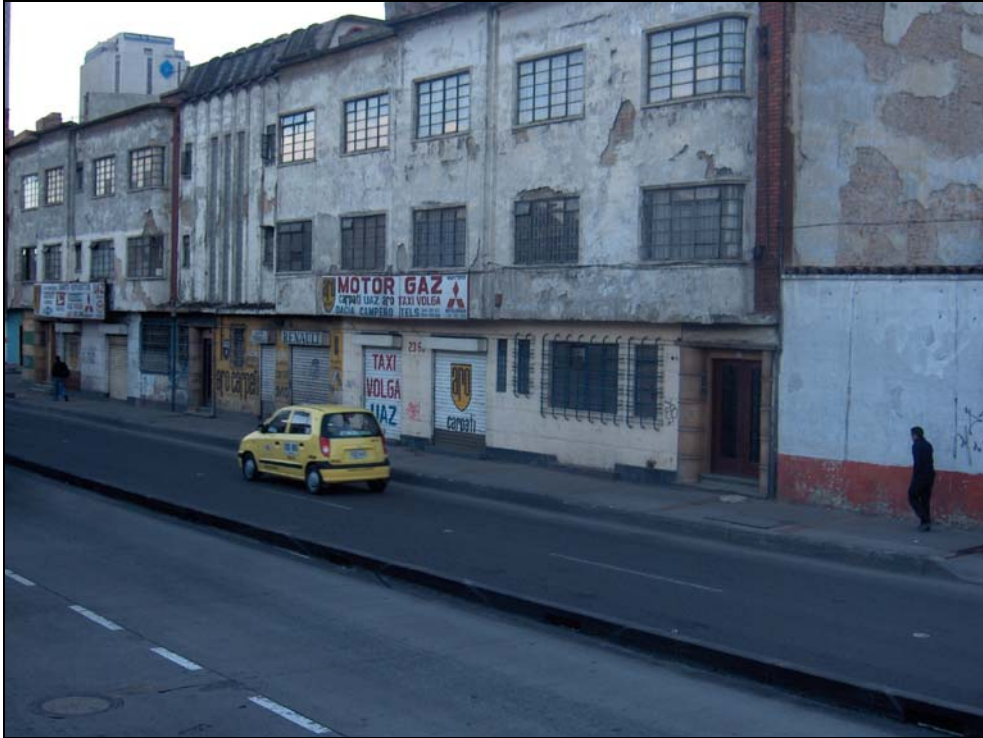
Figura 4.22 – Foto do centro tradicional, construções em avançado estado de deterioração. Fonte: Arquivo do Autor.
