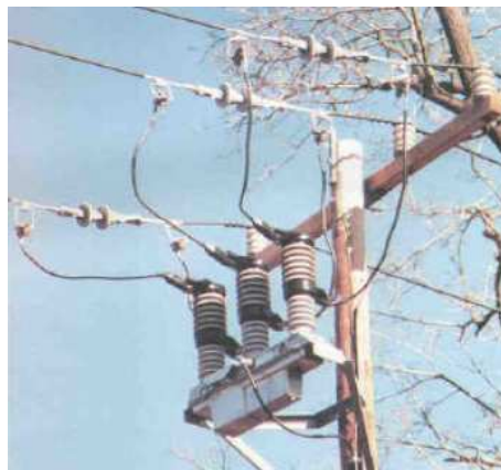
Figura 5: Seccionador automático instalado (JOSLYN HIGH VOLTAGE, 1996).
