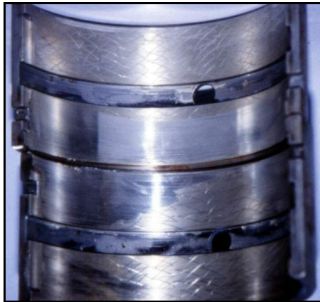
Figura 2.13 – Par de conchas de mancal mostrando região lisa nos lados opostos das conchas ( Failure Investigation , www.tribology.co.uk ).
