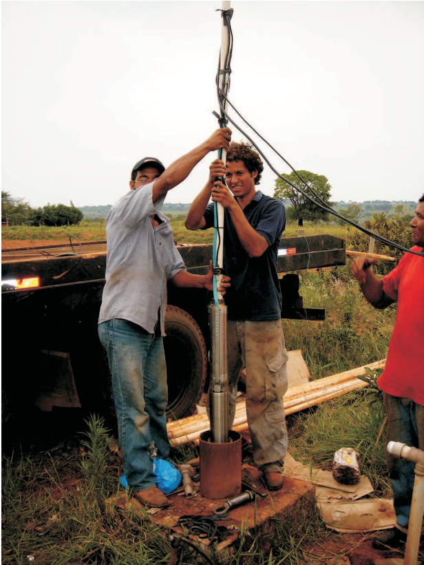
Figura 3.17: Instalação da motobomba.
