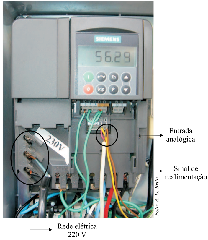
Figura 3.5: Vista do conversor de frequência utilizado - Micromaster 420 de 2 CV.
