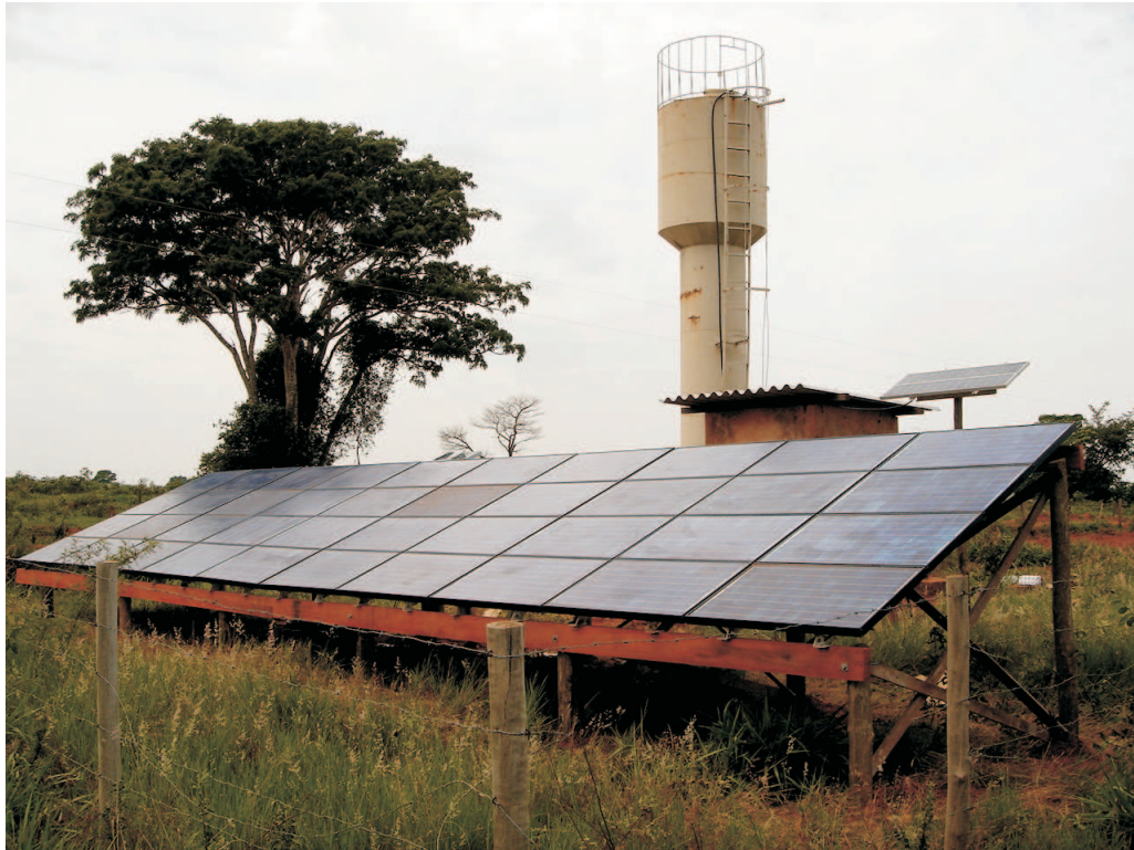
Figura 3.20: Vista do SBFCF instalado.
