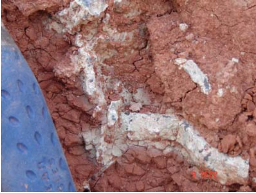
Figura 22. Carbonatação de fendas.
