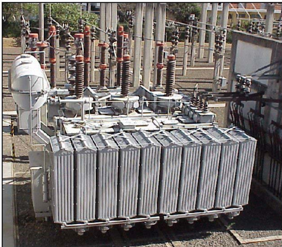
Figura 6.2: Transformador Monitorado (TR-3 Campinas CPFL) Potência 50 MVA e Tensão Nominal 138kV / 11.95kV.
