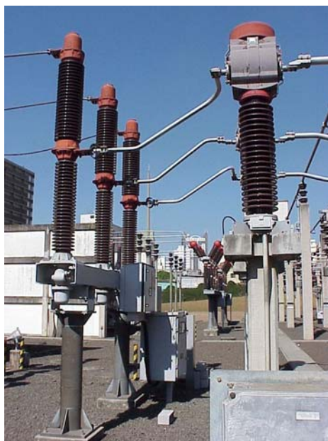
Figura 5.2: Disjuntor SF6 Siemens de 138 kV com comando hidráulico (CPFL SE Campinas Centro).
