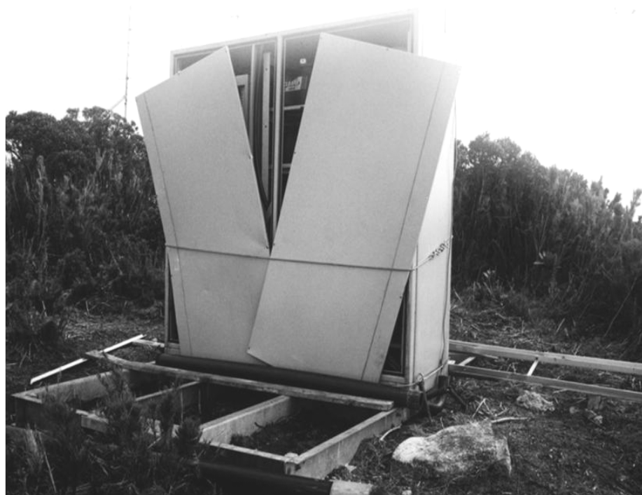
FIGURA 13 - ESTRUTURA PARA RÁDIO DO PRÓ-ATLÂNTICA E VEGETAÇÃO NATURAL DESTRUÍDA NO MORRO CARATUVA, ALTO DA SERRA DO MAR PARANAENSE. In: LORENZETTO, 2005.
