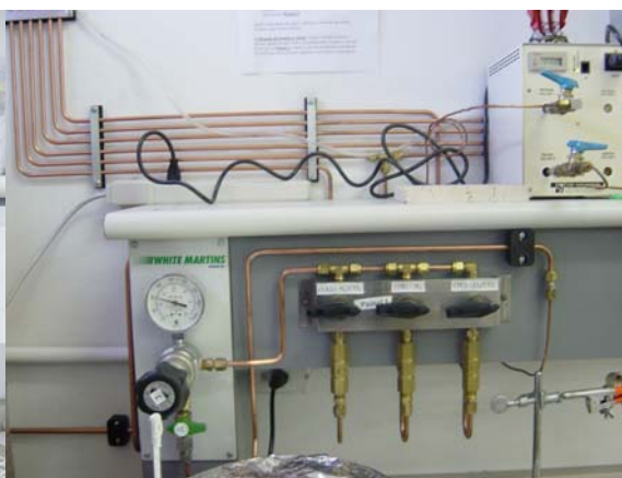
Figura 3 – Detalhe da válvula de gases
