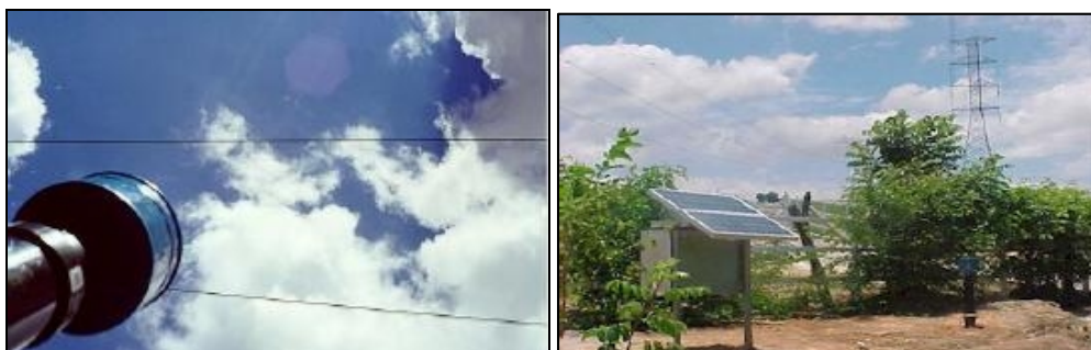
Figura 2.3 - Sistema SONAR Instalado na LT Neves da CEMIG.
