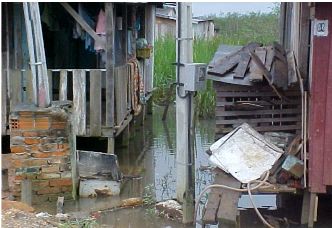
Figura 7 – Moradias sujeitas à inundação. Foto: Oswaldo Schuch – outubro/2004
