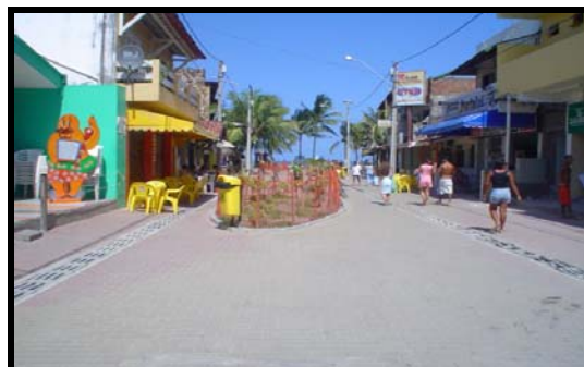
Figura 8.16 – Foto da Rua da Esperança após terminada a primeira etapa (Julho/05) Fonte: Arquivo da autora
