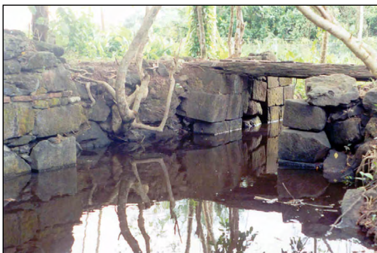
Figura 48. Imagem da estrutura da barragem do engenho Uriboca construída em alvenaria de pedra lapidada, em processo de arruinamento, agravado com a construção da rodovia Alça Viária.
